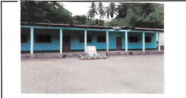
Foto 1: Techo en mal estado
