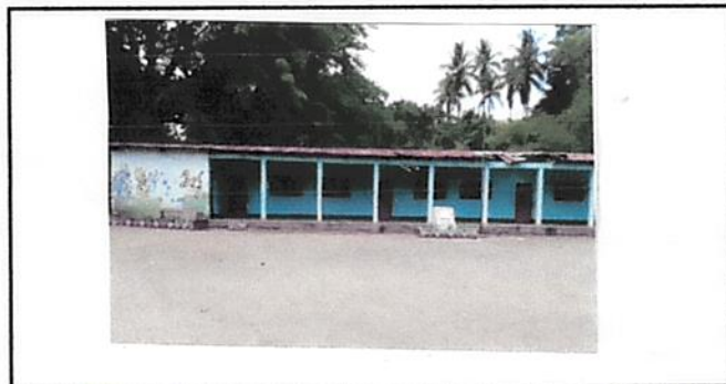
Foto 6: Techo en mal estado
