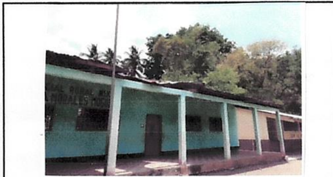
Foto 3: Techo en mal estado
